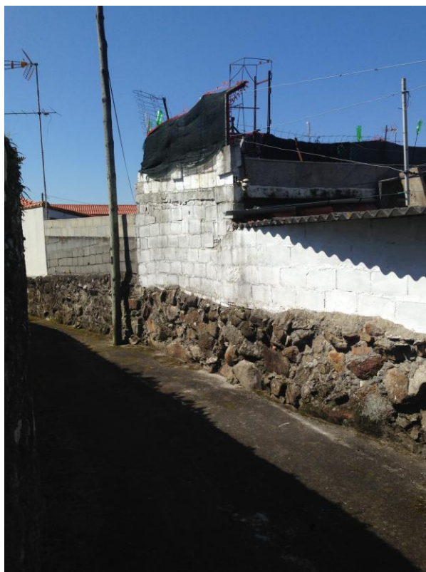
Figura 11 – Desqualificação dos elementos construídos
